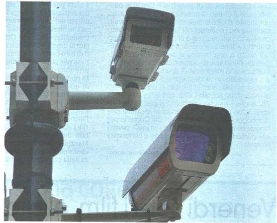
Il Centrodestra Unito chiede di verificare il funzionamento di tutti gli impianti
