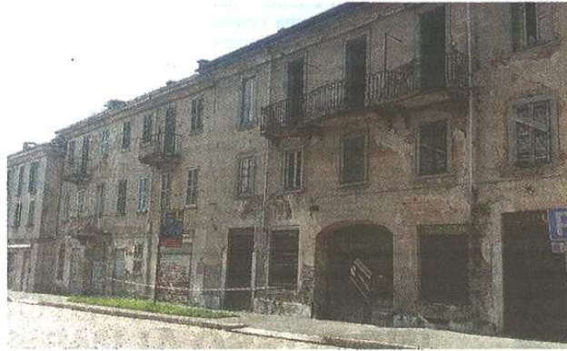
Lo stabile diroccato che incombe sulla sicurezza di corso Matteotti
