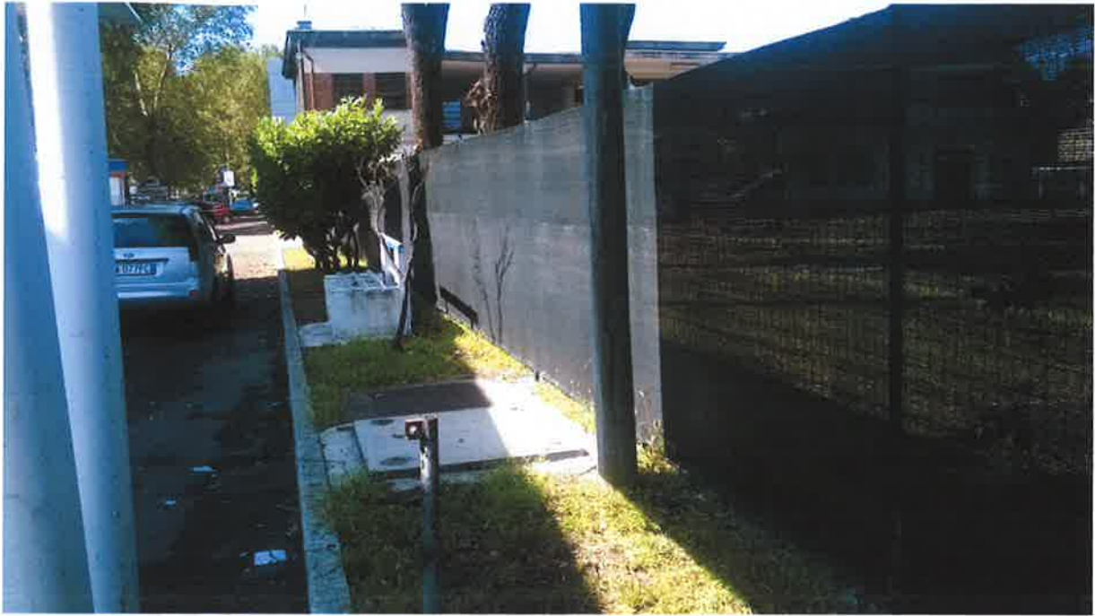
Foto n°6 Particolare recinzione su piazzale stazione di servizio su S.S. N°33 Vista da esterno stadio
