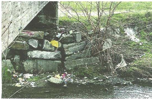
Muretti spaccati a Castegnate, rifiuti sotto il ponte. Posizionando lo smartphone sul QR code si accede a una carrellata di foto di degrado
