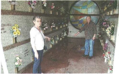
Due cittadini mostrano le condizioni dei loculi del cimitero
