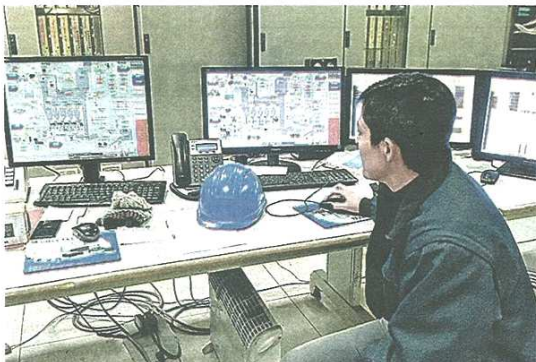
Un interno della "cabina di regia" dell'inceneritore di Borsano
