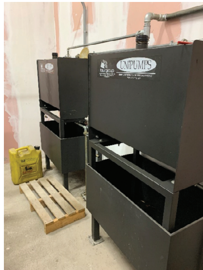
Foto 3 – Gasolio alimentazione pompe anti-incendio
