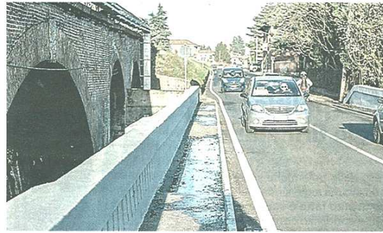
Castellanza: il ponte in via Piave attende un'opera di messa in sicurezza. I lavori sulla struttura, che risale al 1913, saranno realizzati il prossimo anno
