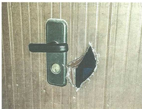
I ladri creano dei fori per poter aprire le serrande dei garage (Blitz)
